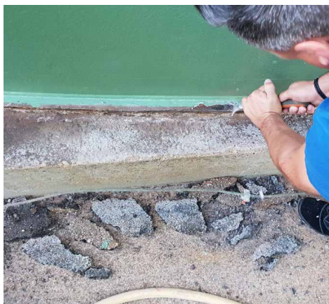
Schritt 2: Entfernen aller artigen und artfremden Verunreinigungen, Rost und schlecht haftender Altschichtungen; Vorbereiten des Betonuntergrundes.
